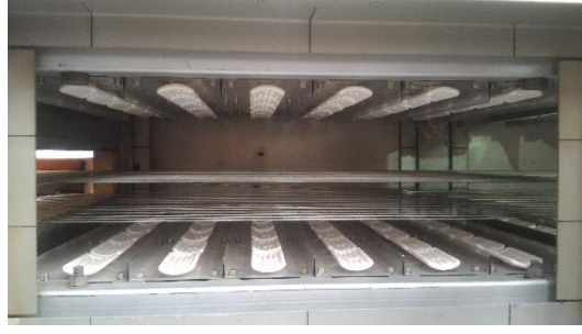
Şekil 6 Tel Konveyör Sisteminin Fırın İçerisindeki Görüntüsü
